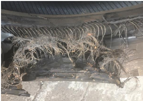
Imagem 8: Fios expostos sem nenhuma cobertura de borracha.
