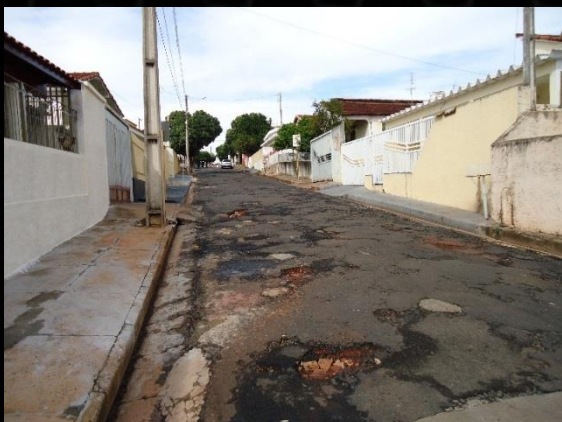
Rua com buracos que geram arrancamentos na banda de rodagem.
