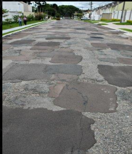
Rua com remendos que também geram arrancamentos na banda de rodagem.
