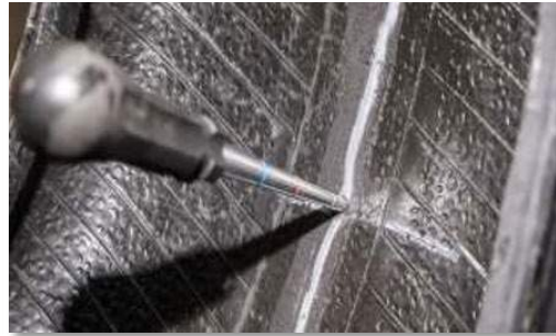
Figura 10. Identificación del tamaño y el ángulo de los daños
